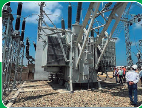
Subestación Nueva Tumbes Acciona
