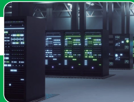
Data Center de Win Empresas Sinerge
