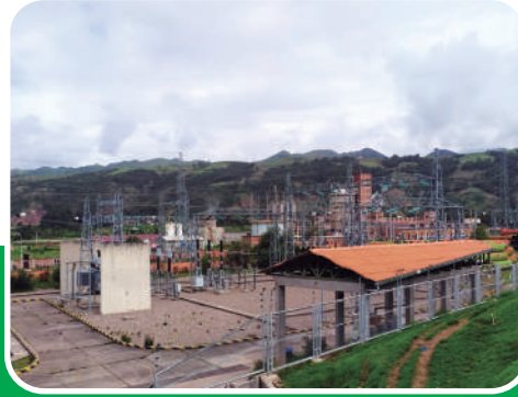
Sub estación eléctrica de Cachimayo Construcciones Electromecánicas Delcrosa
